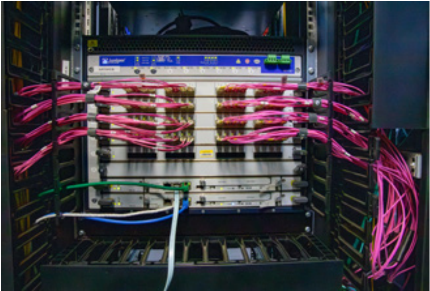
Datenknotenpunkt im firstcolo Rechenzentrum Werkhaus (Foto: Achim Halfmann)
